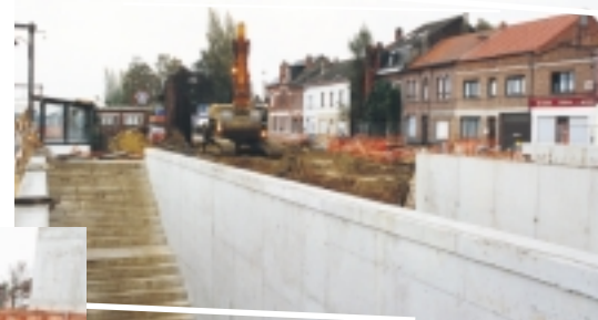
De opgefriste stopplaats Veltem-Beisem krijgt een nieuwe onderdoorgang met goed verlichte toegangshellingen en -trappen.
