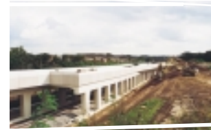
In de omgeving van de Abdij van Park komt een nieuw kruisingscomplex. Hier zullen de bestaande spoorlijn 36 en de nieuwe hsl elkaar kruisen.
