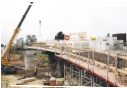
De nieuwe brug aan de Mechelsesteenweg wordt gebouwd naast de bestaande en zal aansluiten op de Frans Mombaertsstraat.
